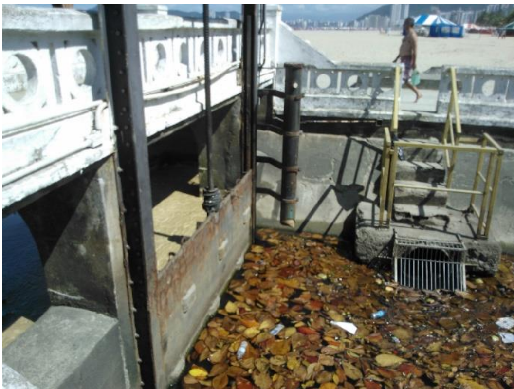
Figura 6. Sistema de comportas. Comporta fechada no canal 3, isolando as águas do mar e areia das águas e componentes presentes no canal (sistema de drenagem pluvial).
