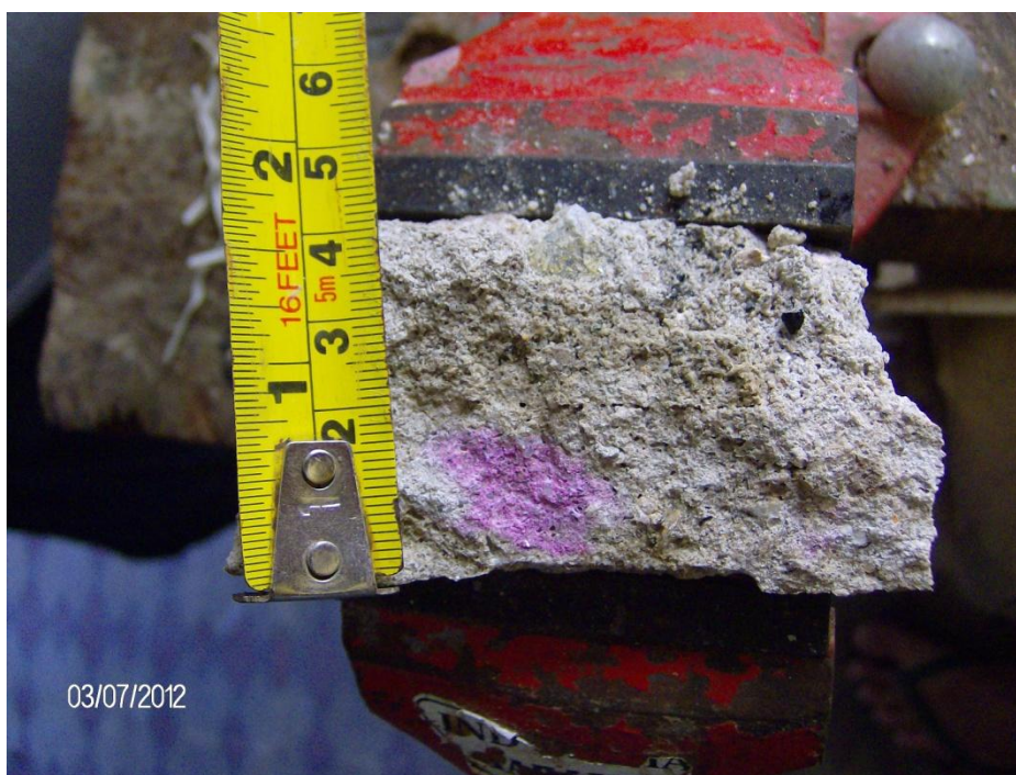
Figura 6: Concreto com idade acima de 30 anos, condições de exposição atmosférica sem proteção de revestimento. Teste de fenolftaleína.
