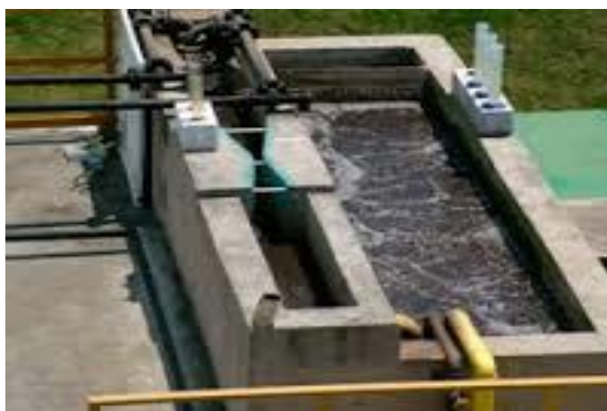
Figura 3: Instalações de unidade de lodo ativado (Saneamento.poli.ufrj.br, 2013).
