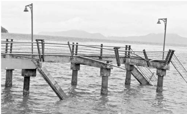
Tábuas levantadas, metal retorcido e um cenário de devastação: em abril, o Deck já havia sido interditado por causa da ação do mar
