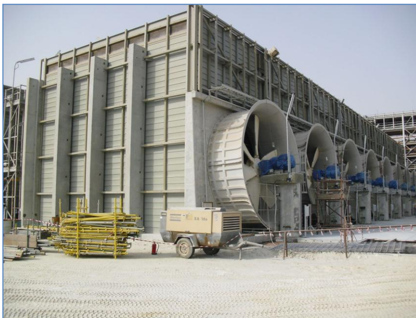
Figura 5 - Torre de tiragem mecânica forçada. Fonte: HAMONGROUP, 2016.
