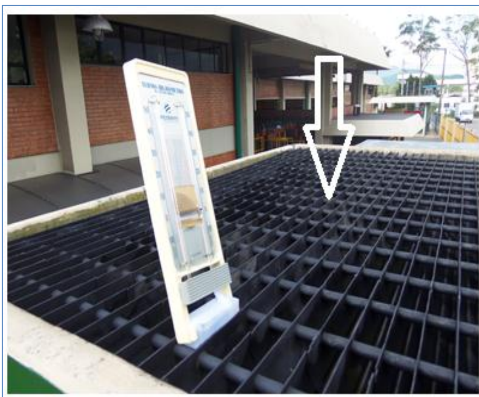
Figura 12 - Eliminador de gotas de uma torre de tiragem mecânica forçada.
