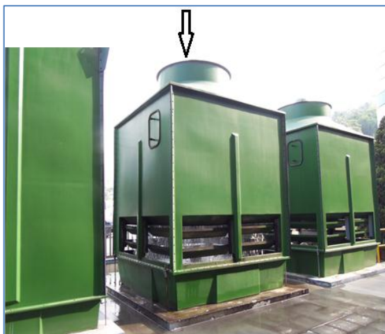
Figura 25 - Pontos de medições das velocidades de ar de saída da torre de tiragem induzida.
