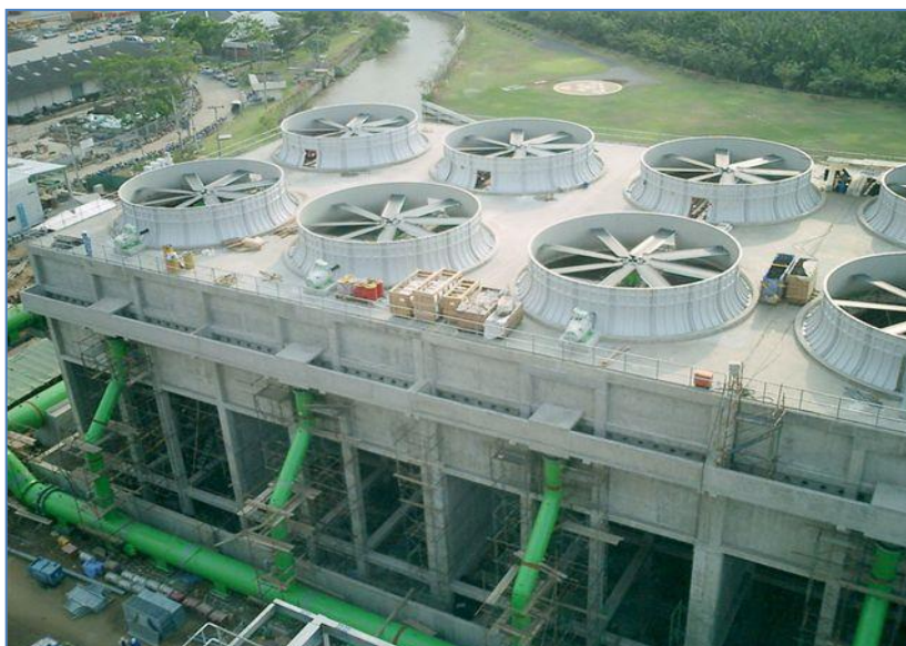
Figura 6 - Torre de tiragem induzida.
