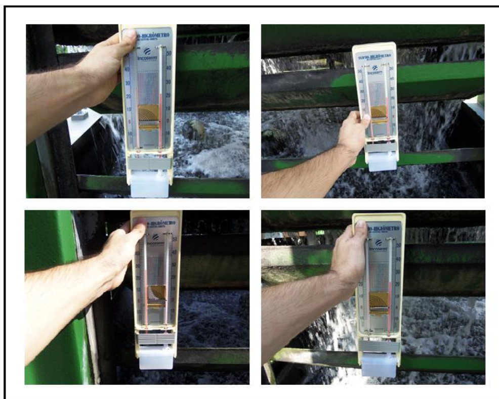
Figura 21 - Medições das temperaturas de bulbo seco e úmido nas entradas de ar da torre de tiragem induzida.
