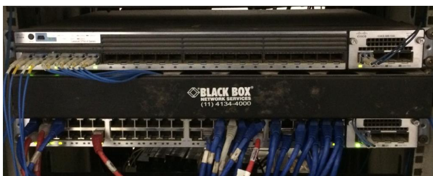
Figura 40 - Comutadores de rede instalados na rede piloto.
