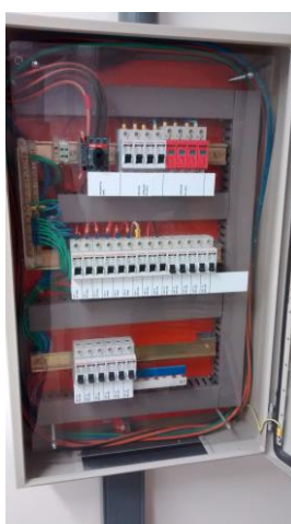
Figura 27 – Quadro de distribuição de energia.
