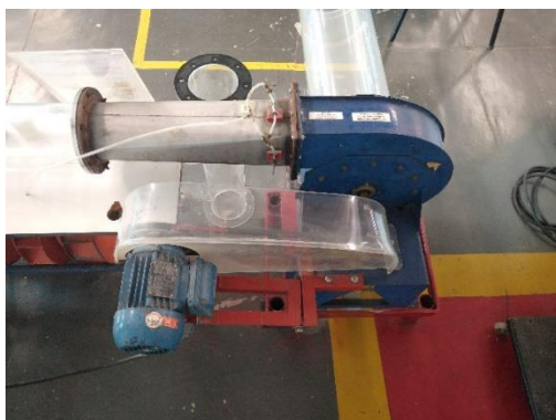
Figura 10 – Mecanismo de ventilação da Unidade Piloto (AUTOR, 2022)
