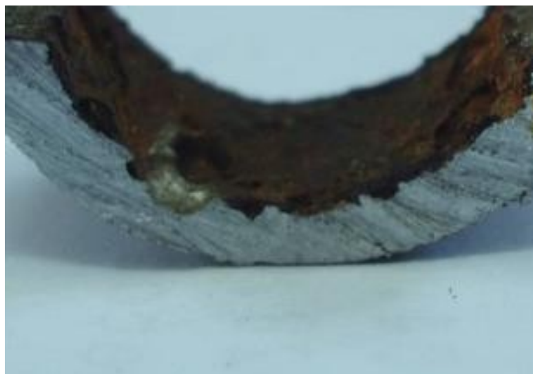
Figura 5- Perda de espessura interna causada por corrosão microbiológica
