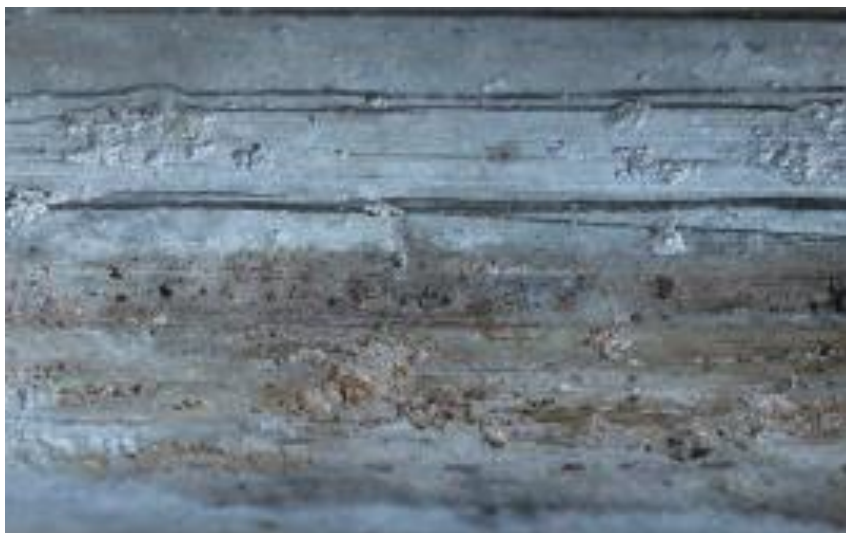
Figura 16- Superfície interna do tubo de purga com presença de áreas de corrosão
