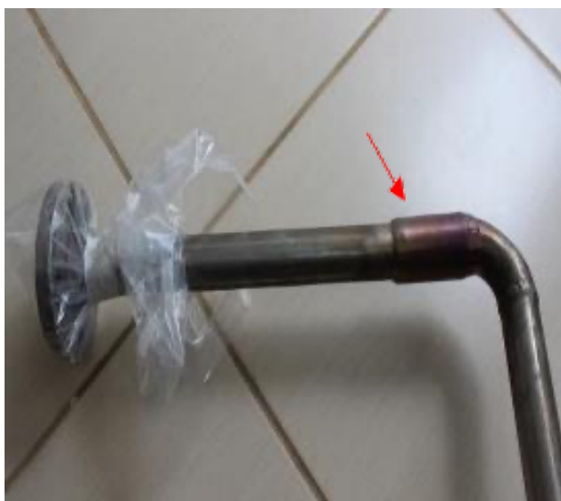
Figura 4- Tubo de purga sistema de degasagem do trocador de calor
