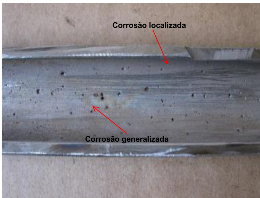
Figura 23- Vista da superfície interna tubo do trocador com presença de corrosão localizada e generalizada
