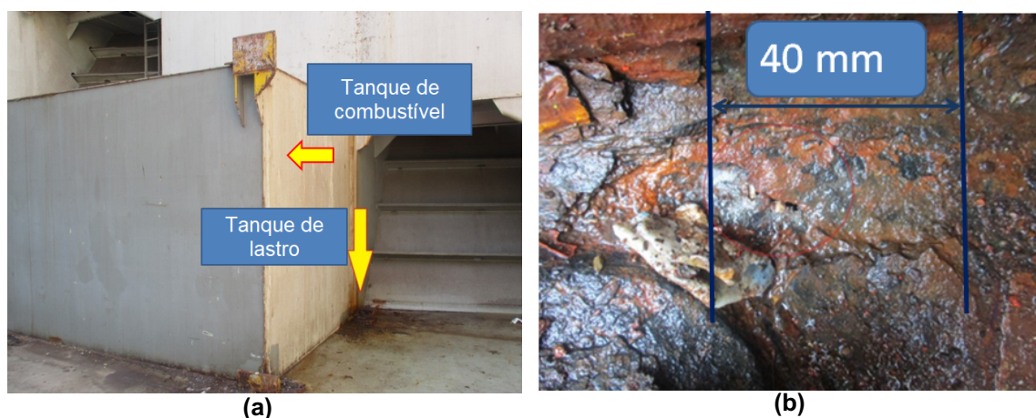
Figura 5: (a) Exemplo de corrosão- tanque de lastro- localização no deck e (b) detalhamento da trinca aparente no tanque de lastro. Fonte: autor (2019).
