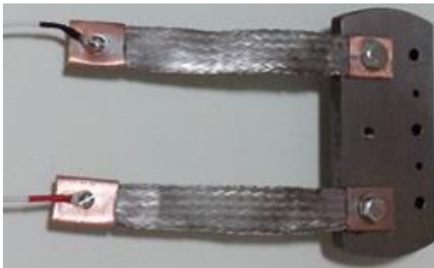
Figura 34 - Cordoalhas completas com cabos.
