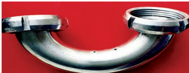
Figura 14 - Corrosão por pite em aço inoxidável (Fonte: Gentil, 2011).
