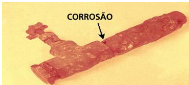
Figura 16 - Corrosão galvânica em contato de aço-carbono com latão (Fonte: Gentil, 2011).
