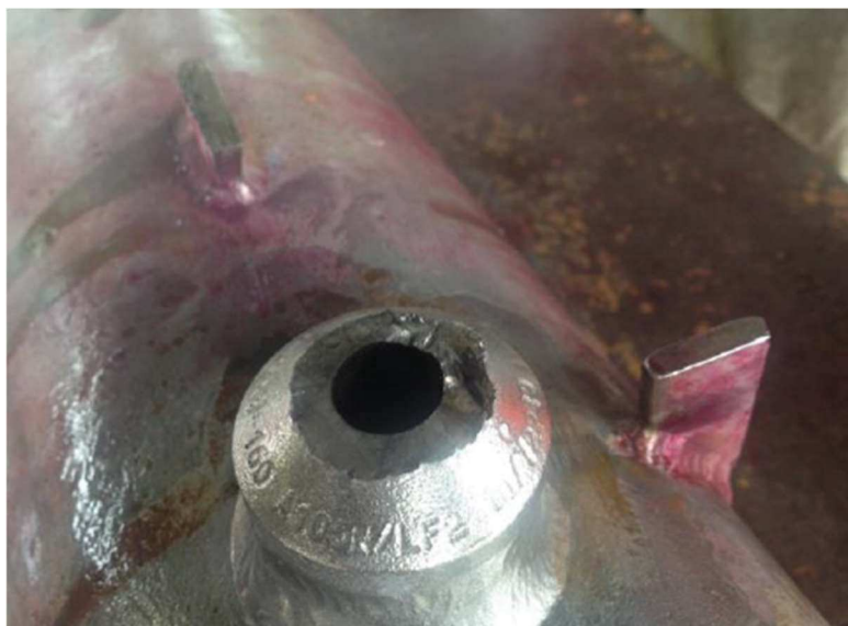
Figura 17 - Conexão da Tubulação onde Ocorreu Falha por VIF. Conforme se pode observar, a falha ocorreu na junta soldada de conexão para derivação de pequeno diâmetro. Fonte: Acervo da PETROBRAS.
