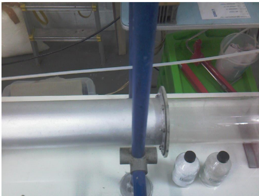
Figura 3.10 – Detalhe da tubulação horizontal da Unidade Piloto
