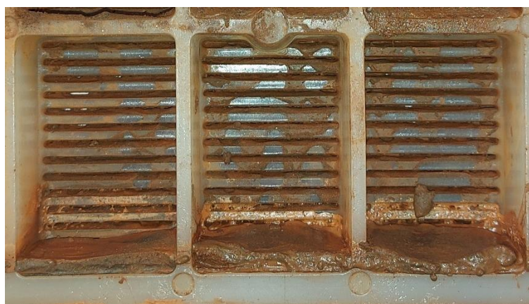
Figura 64 - Deposição de minério em dreno montado na posição horizontal.
