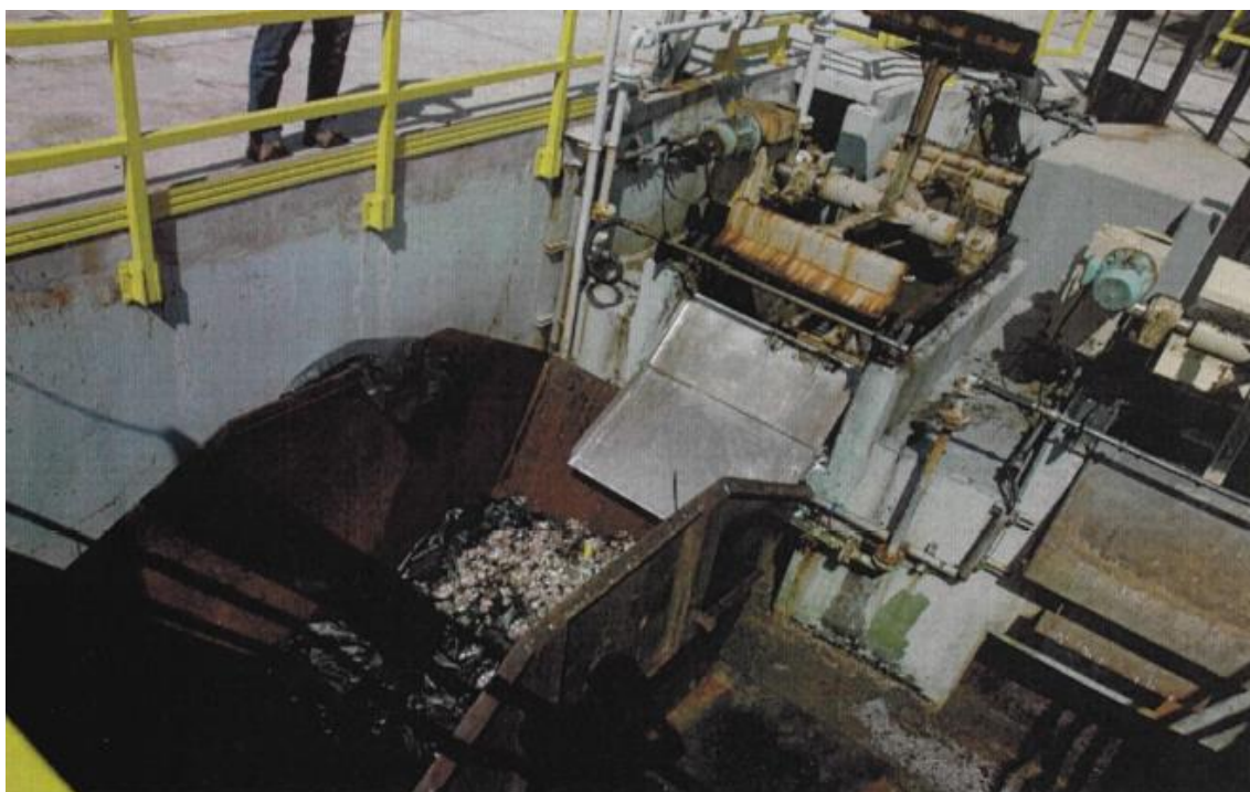
Figura 10. Caçamba onde são depositados rejeitos resultantes da limpeza das grades fixas.
