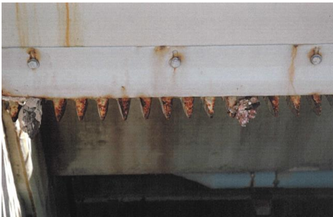
Figura 9. Detalhe dos "dentes" da pá mecânica. Eles se encaixam entre as barras da grade fixa para uma melhor limpeza.
