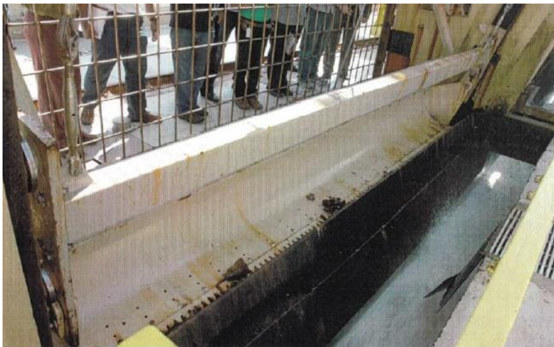
Figura 8. Detalhes de pá mecânica ( skiper ) que limpa a grade fixa. A pá mostrada está na posição fechada em seu curso final, após ter percorrido todo seu trajeto de limpeza. Nessa posição os resíduos são depositados na canaleta com jatos d'água que conduzem os detritos para uma caçamba, comum para as suas estruturas de limpeza. O conteúdo recolhido é visível para os funcionários do setor.
