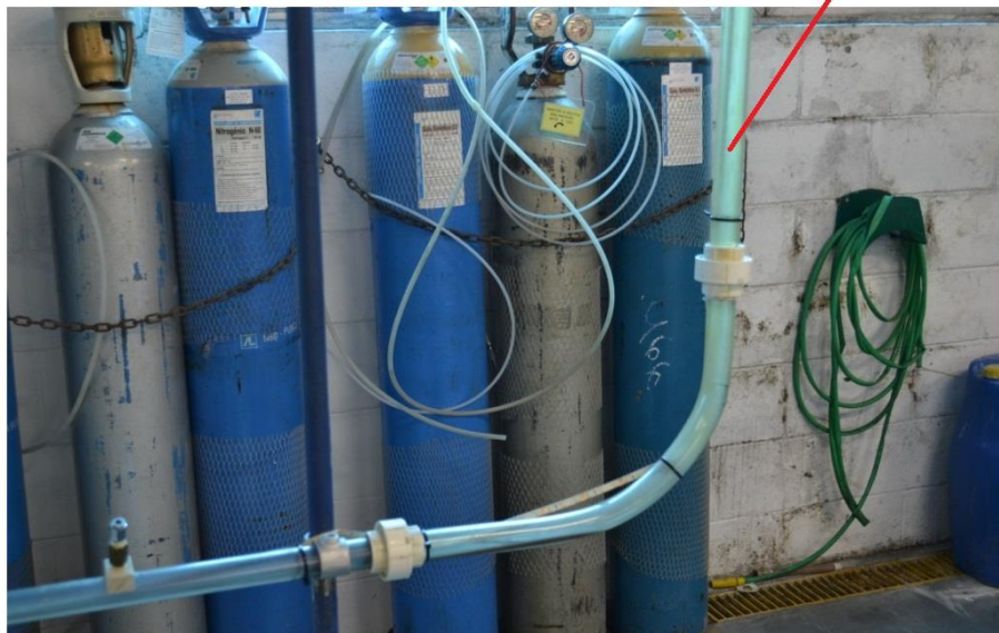
Figura 3-13 - Detalhe do ponto de instalação do sensor após a primeira curva.
