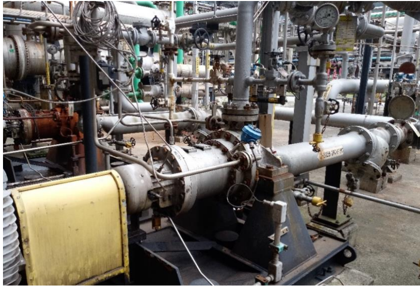
Figura 30. Bomba centrífuga instalada na base.
