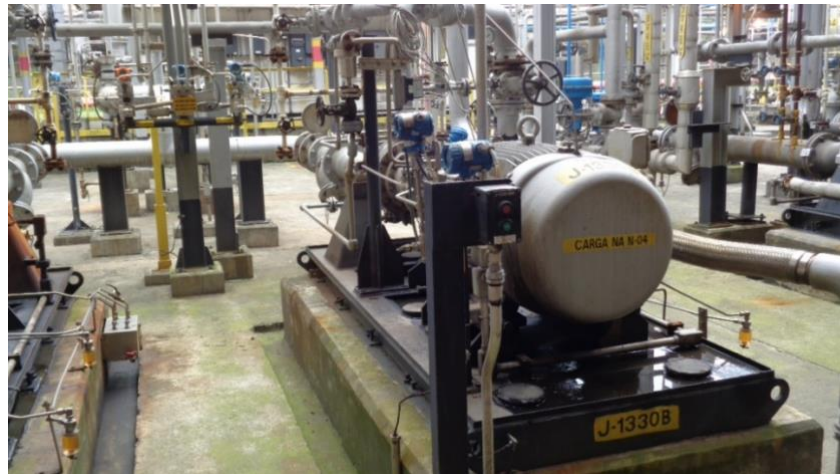
Figura 28. Visão geral do conjunto acionador e acionado.
