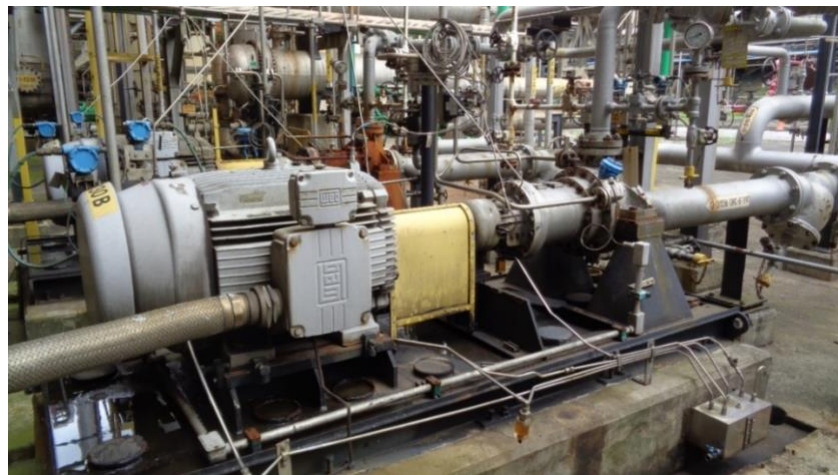
Figura 29. Visão geral do conjunto acionador e acionado.
