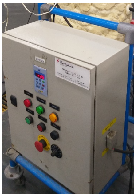
Figura 34 - Inversor de frequência.
