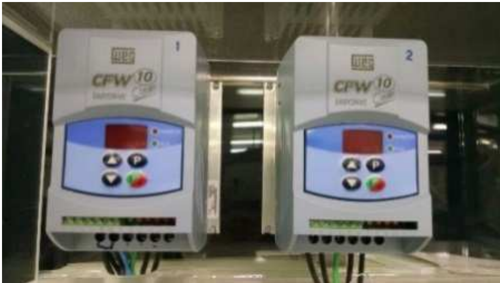
Figura 4.8 – Inversor de frequência.
