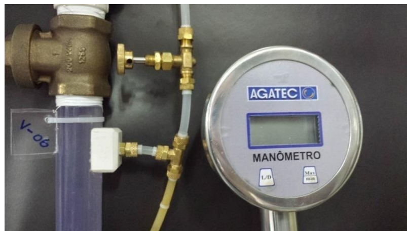
Figura 3.5: Tomadas de pressão e manômetro digital.
