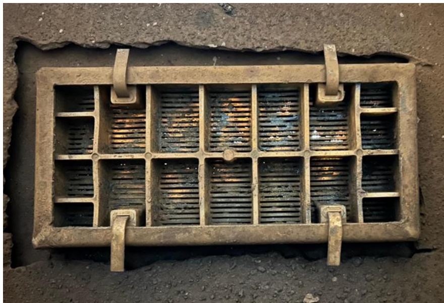
Figura 11 – Dreno entupido, visão inferior. (Fonte: autor)
