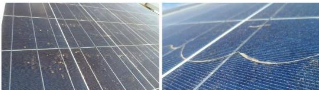
Figura 3 - Deposição intensa de poeira sobre a superfície da placa fotovoltaica
