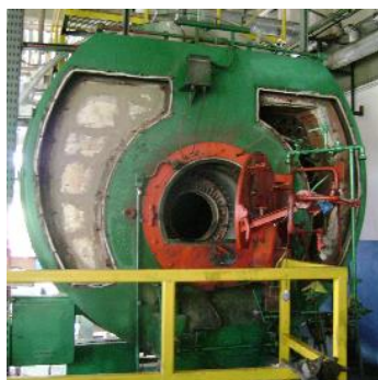
Figura 4 - Detalhe da frente da caldeira sem o queimador
